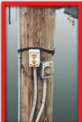
Prise de courant corrodée par l'air salin et les embruns
